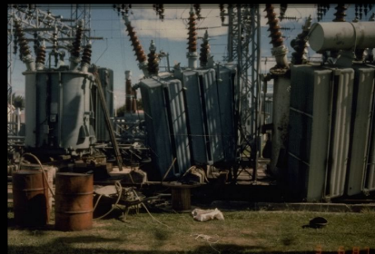
< Edge Cumbe 지진 - 변압기의 파손 >
