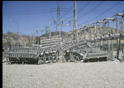
< San Fernando 지진 - 송전설비 파손 >
