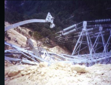
< Chi-Chi 지진 - 송전탑 파손 >
