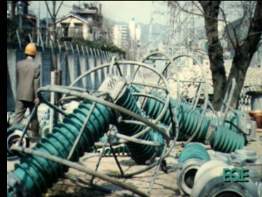
< Kobe 지진 - 변전소 파손 >
